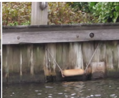
Plaatselijk houtrot in eindstadium,
