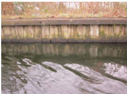
Houtrot in begin en gevorderd stadium
